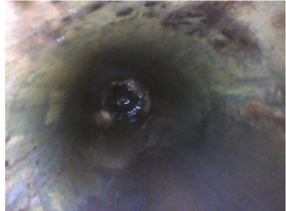
給水管内部腐食状況
