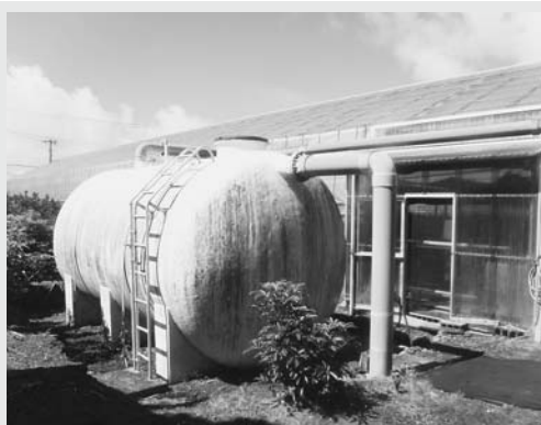
ハウスに設置されている天水用のタンク
