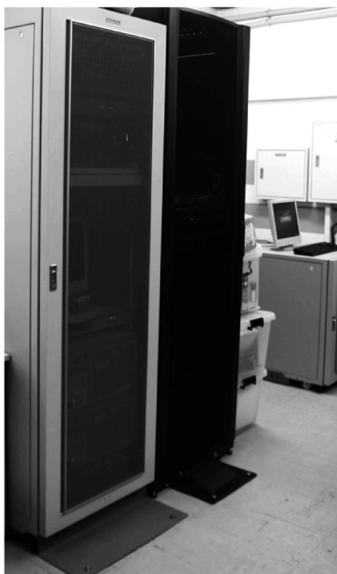
町電算室にあるサーバー
